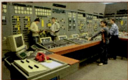
Полномасштабный тренажер блочного щита управления АЭС
