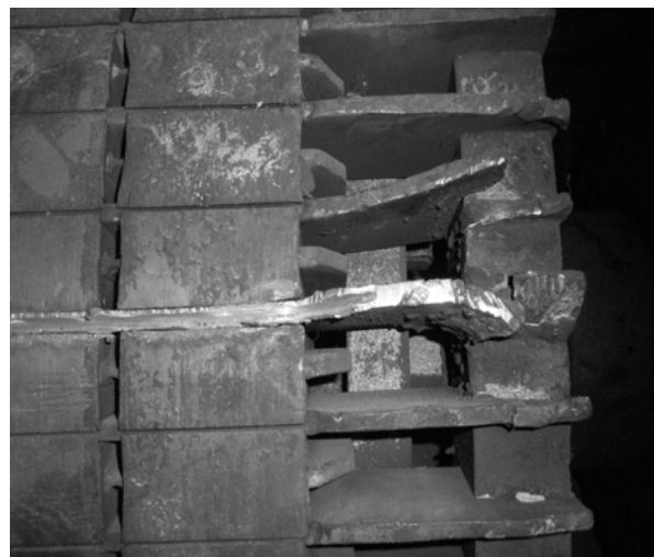
Рис. 1. Фотография поврежденной обмотки ротора
