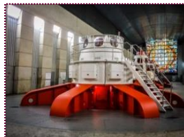
Гидрогенераторы для выработки электроэнергии на ГЭС
