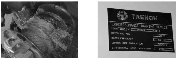
Рис. 1. Поврежденный трансформатор напряжения фирмы Trench TVB sm245
