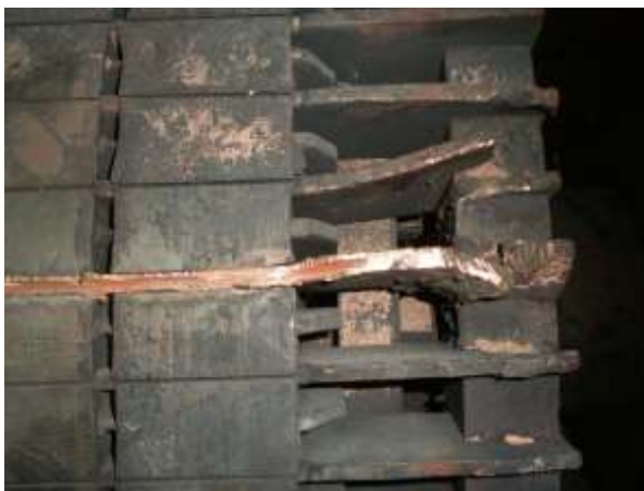
Рис. 1. Фотография поврежденной обмотки ротора
