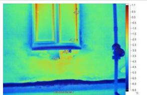
Рис. 2 Термограмма оконных проемов здания Шуйской администрации
