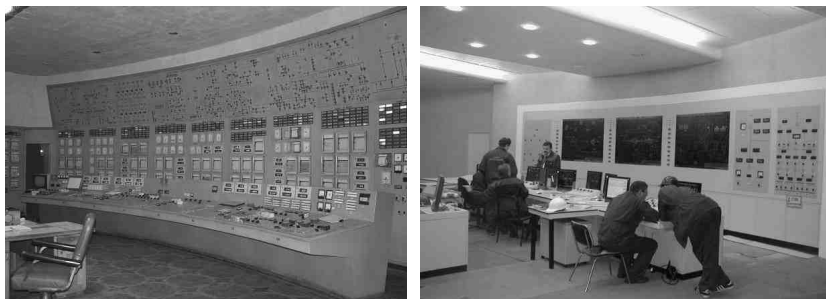
Рис. 2. Блочный щит управления до и после реконструкции
