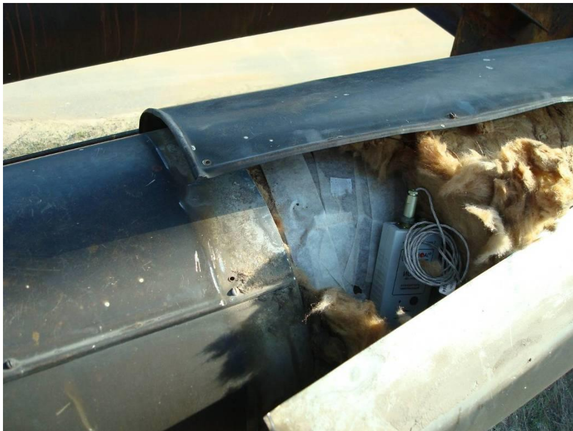
Рисунок 3.14 – Крепление датчика регистратора температуры к трубопроводу большого диаметра
