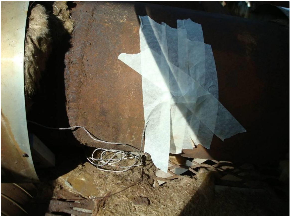
Рисунок 3.13 – Крепление датчика регистратора температуры к трубопроводу большого диаметра
